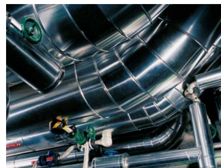
NOVAFLON® vlakke afdichtingen in een energieleidingsysteem
